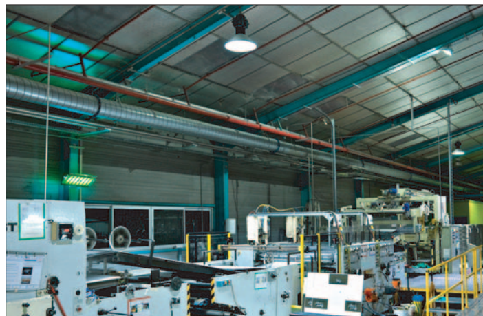
Éclairage de la ligne de transformation
